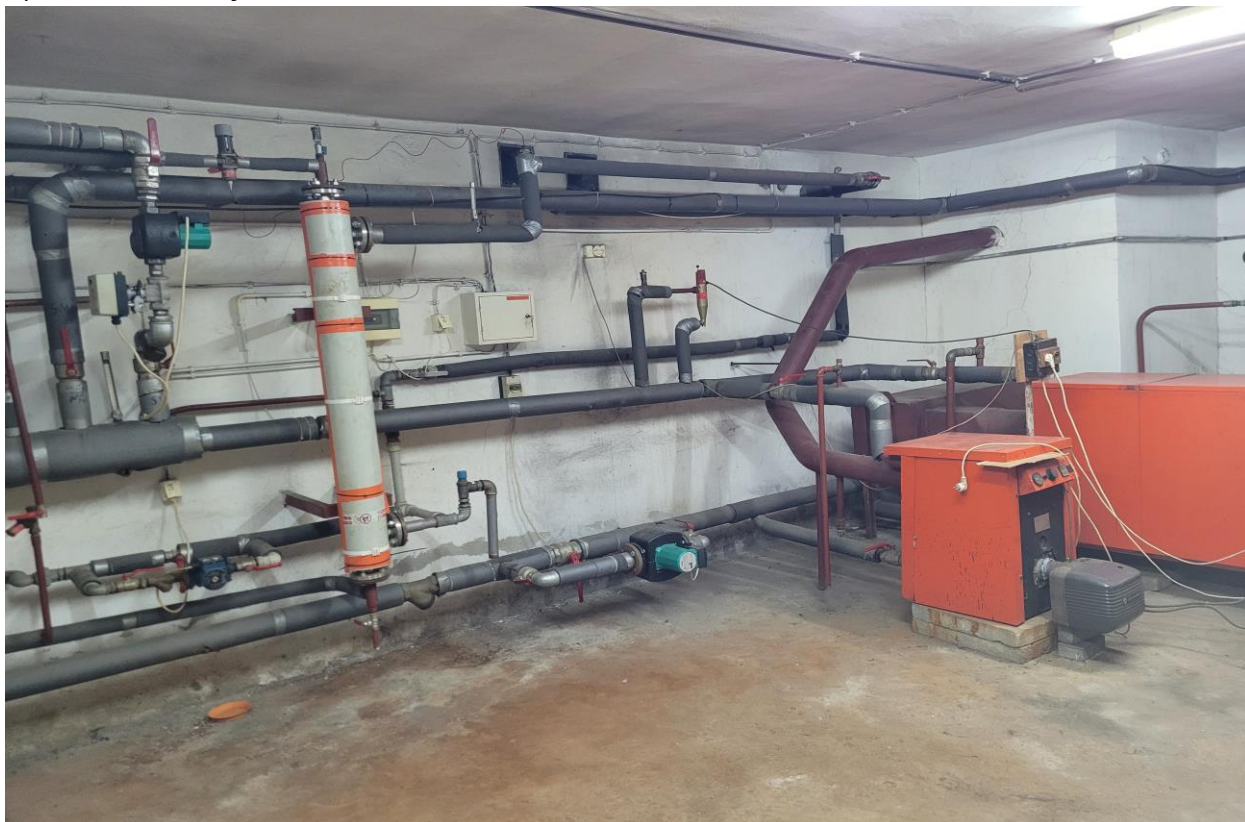
a) Kotłownia olejowa w SP w Gawłuszowicach
