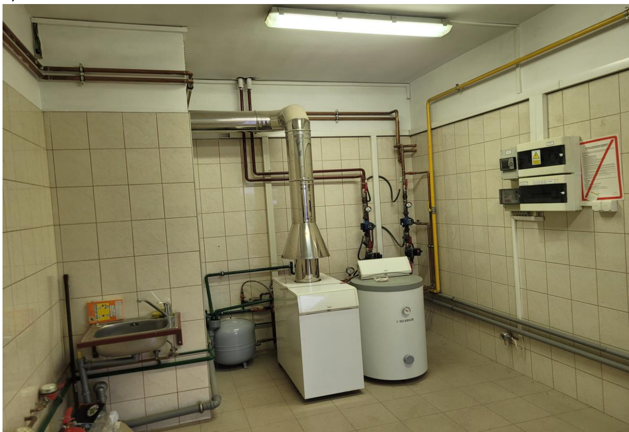
b) Kotłownia w UG w Gawłuszowicach
